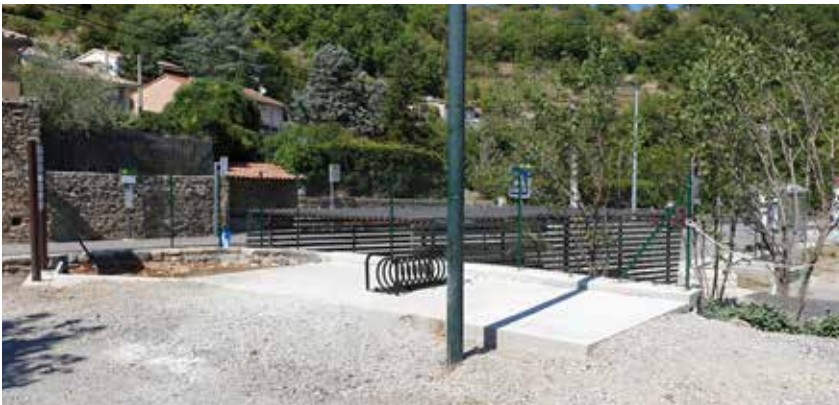
▲ Aménagement de parking vélos, place de la Gare
