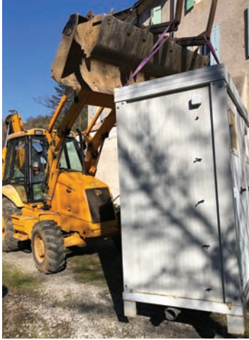
Sanitaires extérieurs parking Fabricou
